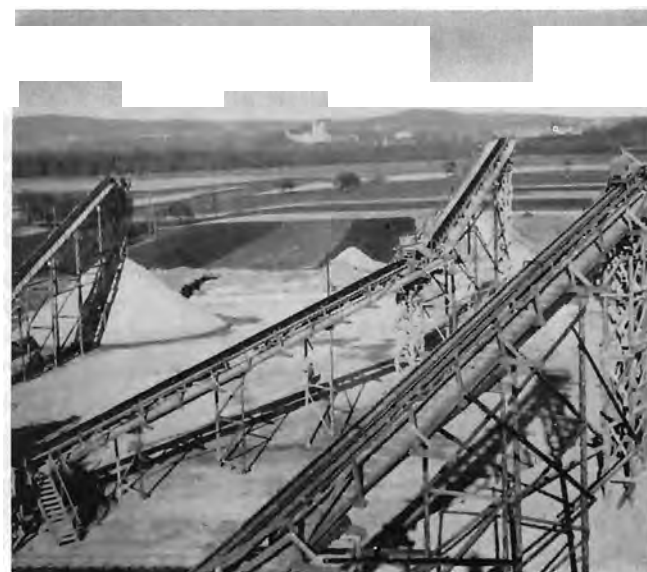
Förderbänder einer Baumaterial-Aufbereitungsanlage Belt conveyors handling building material Bandes transporteuses d'une installation de préparation pour matériel de construction
