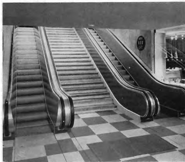
Rolltreppe in einem Fußgängerdurchgang Escalator in a subway for pedestrians Escaliers roulants dans un passage souterrain
