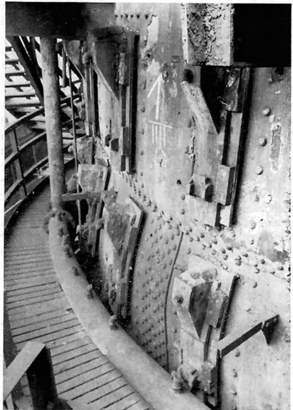
Bild 2: Verformungen im alten, genieteten Schachtmantel eines freitragenden, gerüstlosen Hochofens
