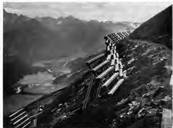
Bild 2: Lawinerverbauung am Heuberg bei Häselgehr, Tirol
