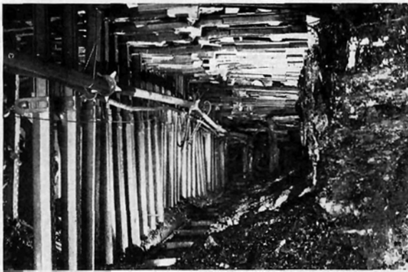
Bild 5: Preßluftleitung mit Kugelschnellverbindung und Wasser-Abspritzleitung im Stahlstreb eines Kohlenbergbaues, 1000 m Unterlage
