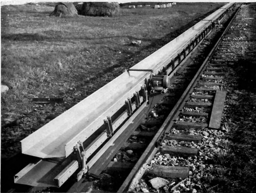
Bild 3: Die Schwingförderstrecke „System Binder“ in leichter Ausführung zum Abtransport von Stahlspänen. Diese Förderstrecke wurde unterflur angeordnet
