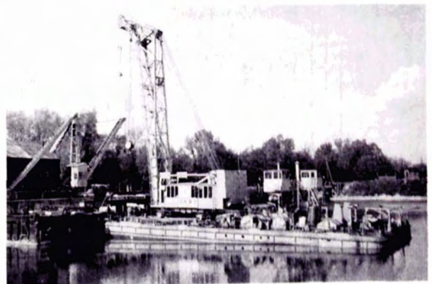
Bild 14: 80-t-Schwimmkran für die DoKW mit drehbarem Kranausleger in geschweißter Fachwerkkonstruktion bei der Probebelastung in der Schiffswerft
