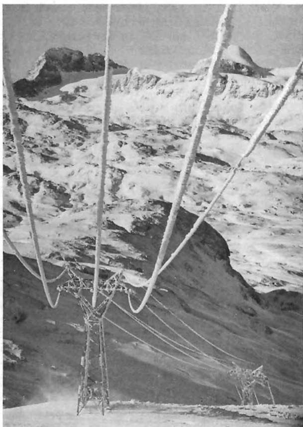
Bild 18: Eisbelastung an einer 110 kV-Leitung im Hochgebirge. Tragmaste aus Kantprofilen, Abspannmaste in gemischter Konstruktion
