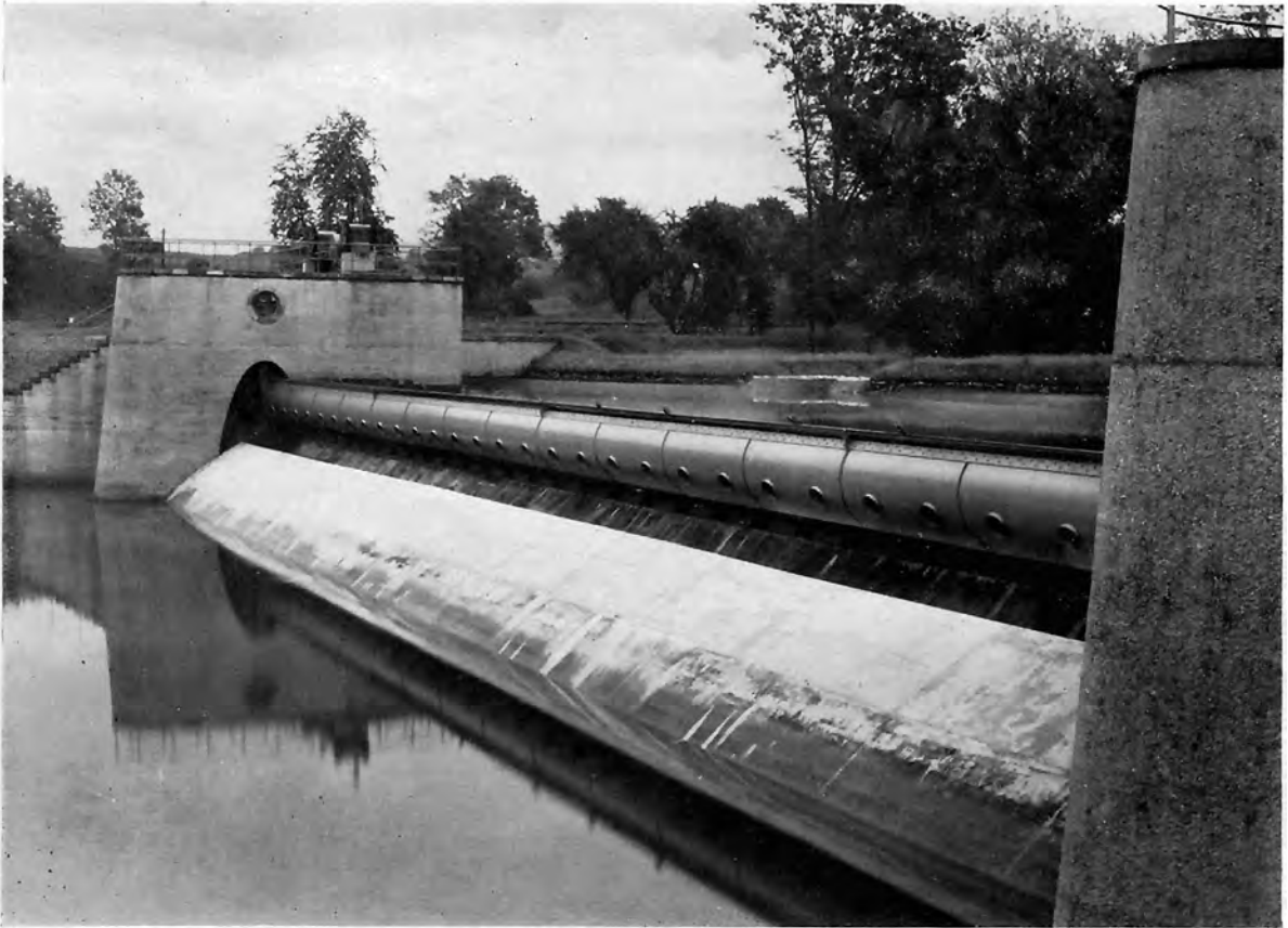
Fischbauchklappe, 48 m lang, an der unteren Erlauf bei Pöchlarn.
