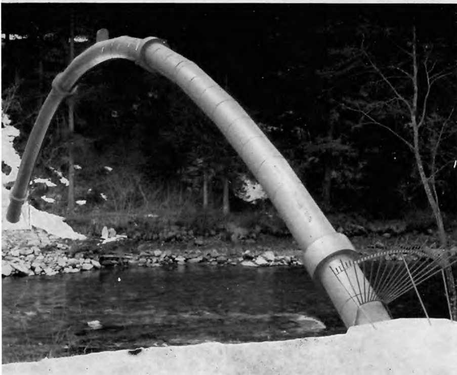
Überführung einer Druckrohrleitung über die Möll, Rohrdurchmesser 600 mm, Stützweite 32 m
