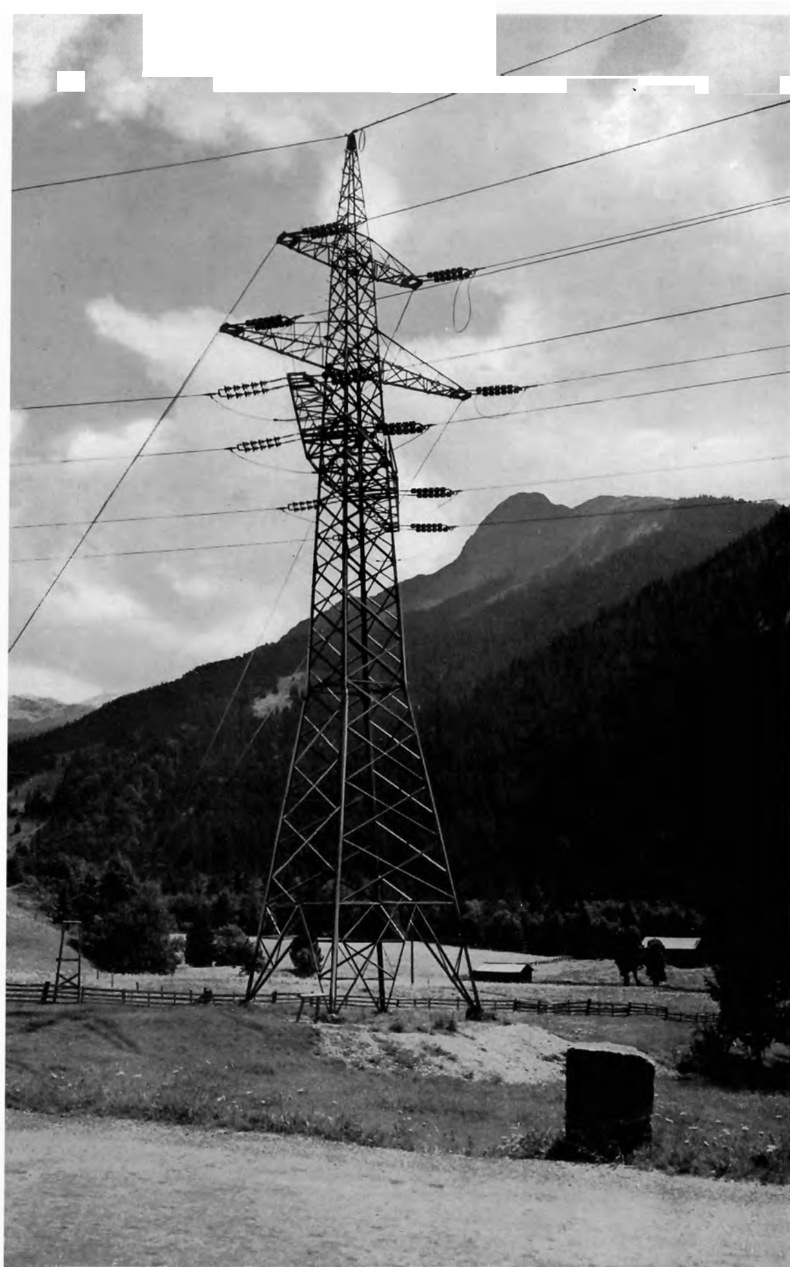
110 kV-Leitung Wald-Braz (Vorarlberg)
