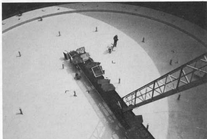
Schwimmdachbeschichtung; ÖMV Schwechat
