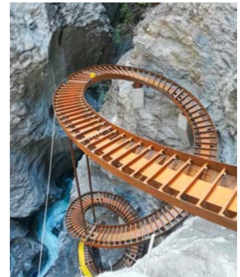
MONTAGE: Fertigstellung Tragkonstruktion ohne Gitterrost und Geländer - vorgefertigte Elemente nr.8 - nr.10 (Montagestützen oberer Bereich)
