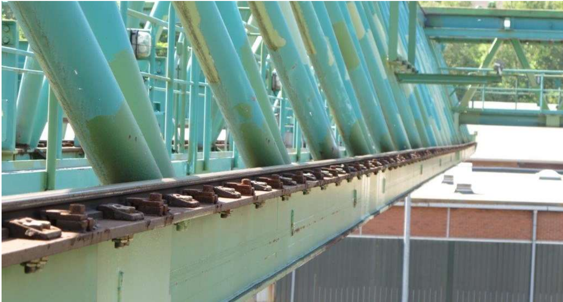
Kranschiene vor der Instandsetzung
