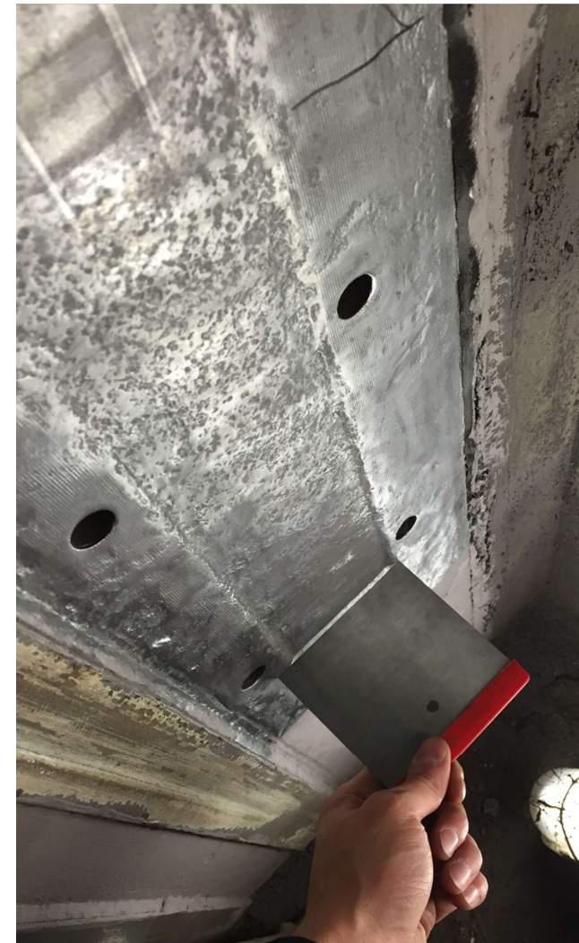
Lauffläche Schleusentor eingelaufen und korrodiert
